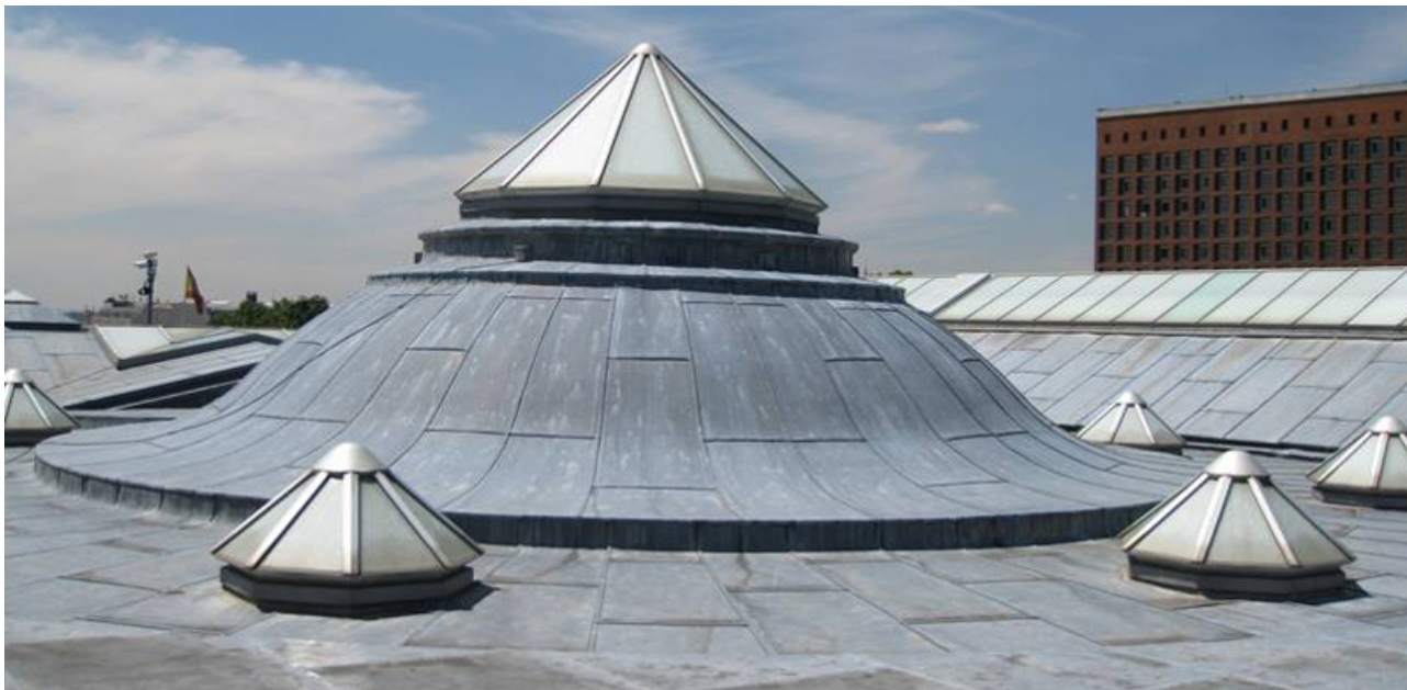
Figura 2. Cubierta plana situada sobre el toro de Goya.
