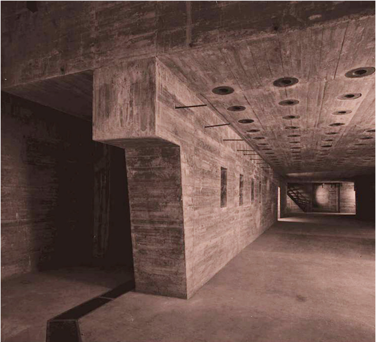
Cara inferior de la losa de carga de la Nave de Ensayos
